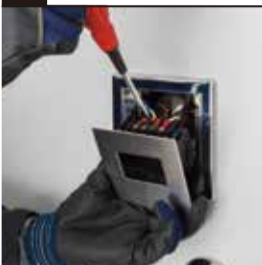
光電センサーに接続されている100V電源の端子を取り外す。
