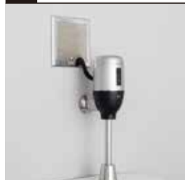
バルブの止水栓を開け、漏水がないか確認する。元電源を復電させ、動作確認を行う。
