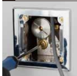
マイナスドライバーで止水栓(開閉ネジ)を閉める。 ※内部に漏水がないか確認してください。
